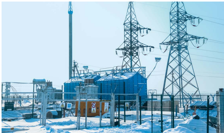
Современное отечественное электрооборудование заменит старое, которое работало с середины 1970-х годов
