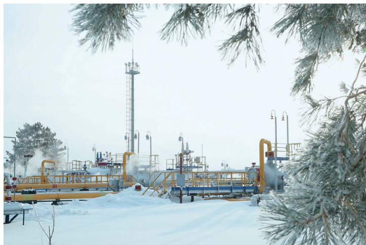
На УКПГ-9 в декабре ввели в эксплуатацию сразу две новые скважины
