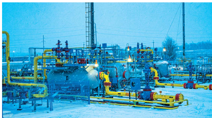
Установка комплексной подготовки газа № 14
