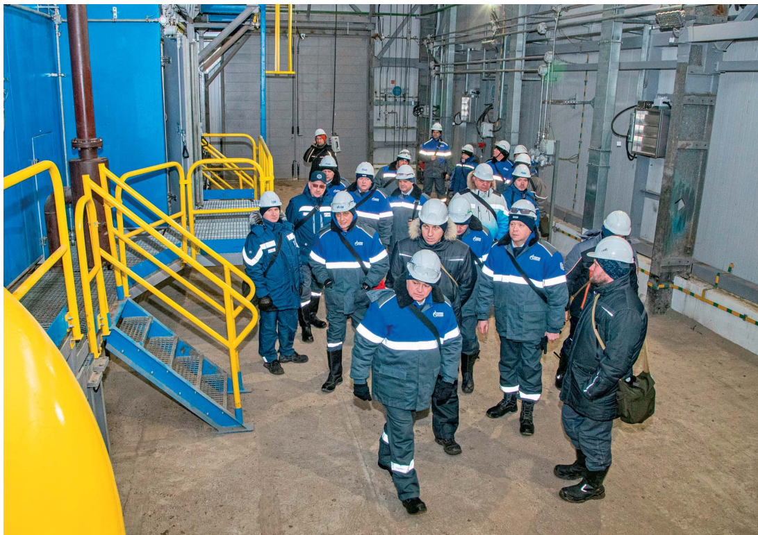
Посещение дожимной компрессорной станции № 2
