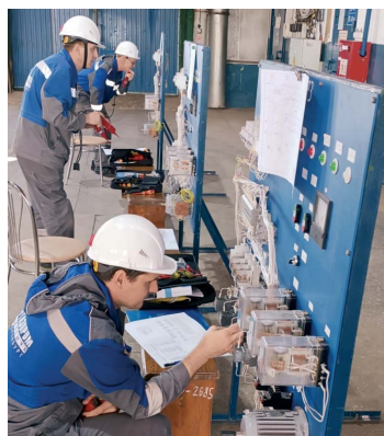
На стенде работают электрики УЭЗиС
