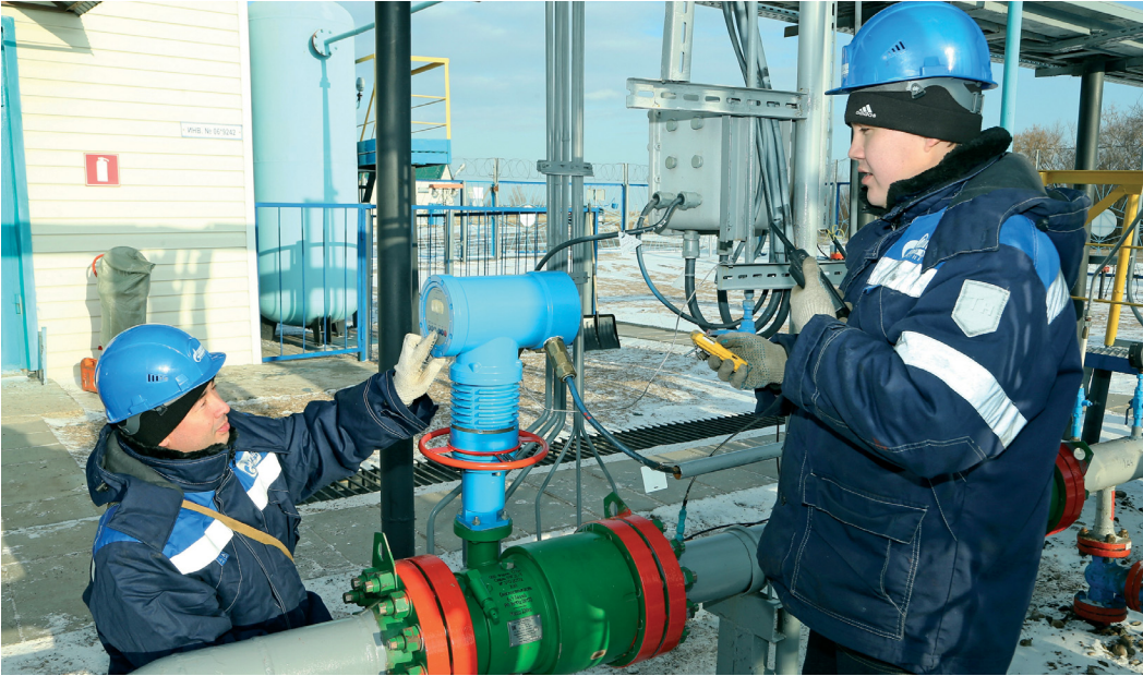
Электромонтер Ирик Нафиков и трубопроводчик линейный Алик Незаметдинов контролируют работу нового оборудования
