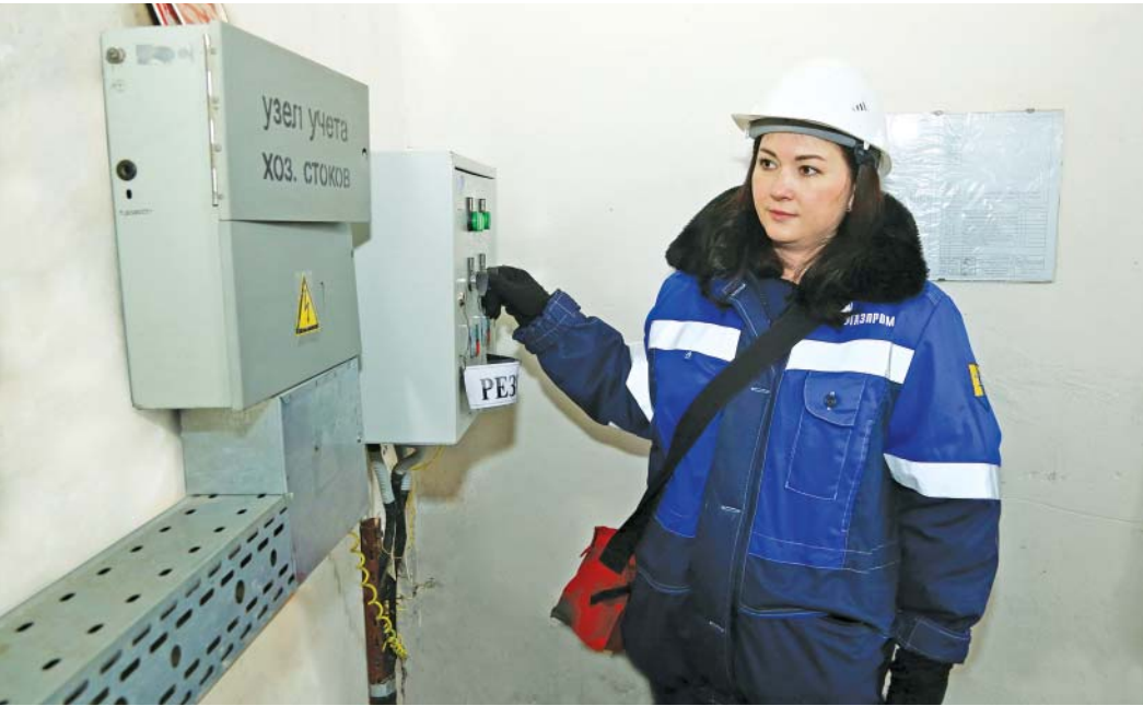
Анна Михайлюк на пульте отключила оборудование и включила систему вентиляции. Через 15 минут можно безопасно спуститься в помещение станции, где находятся насосы
